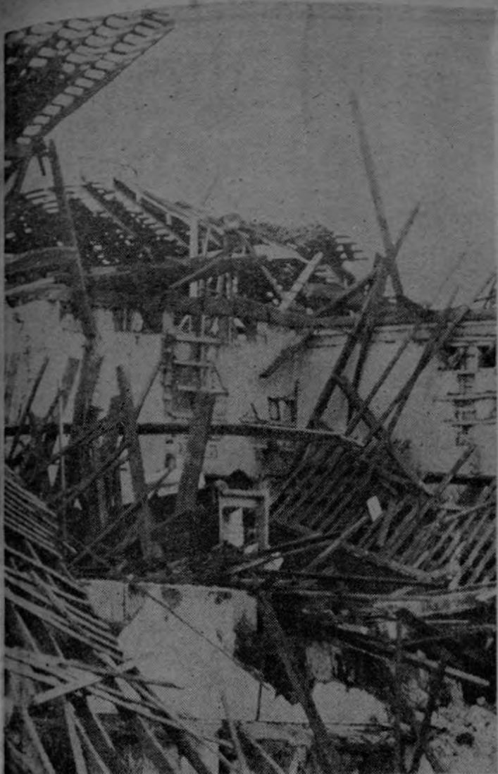
Este edificio se desplomó causando la muerte a varios de sus ocupantes y dejando heridos a muchos más. Nótese que lo que quedó en pie no tiene reparación posible.
